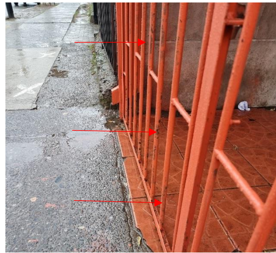
Fotografía N° 16 - Colegio España - Falta de preparación de superficie.
