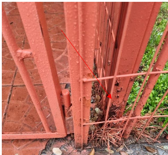
Fotografía N° 15 - Colegio España - Falta de preparación de superficie.
