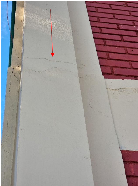
Fotografía N° 31 - Colegio Santa Filomena - Falta de preparación de superficies.
