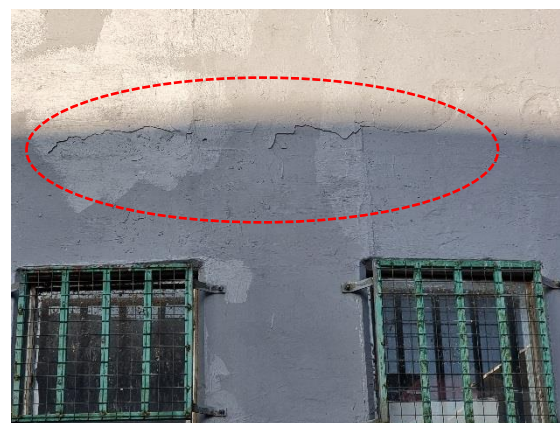
Fotografía N° 18 - Colegio Vicuña Mackena – Deficiente terminación y falta de cobertura.
