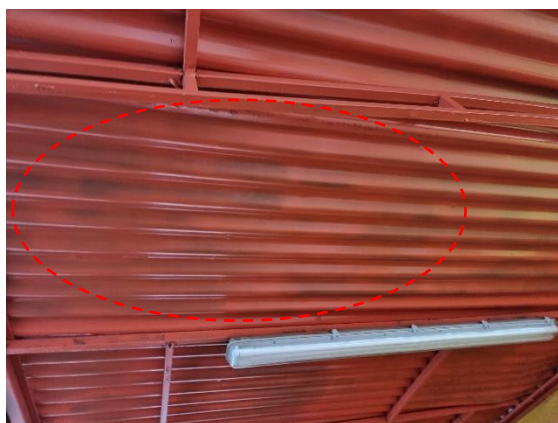
Fotografía N° 17 - Colegio España – Deficiente terminación y falta de cobertura.
