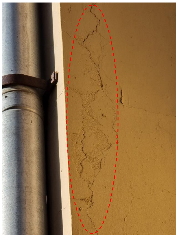
Fotografía N° 27 - Colegio Santa Filomena - Falta de preparación de superficies.
