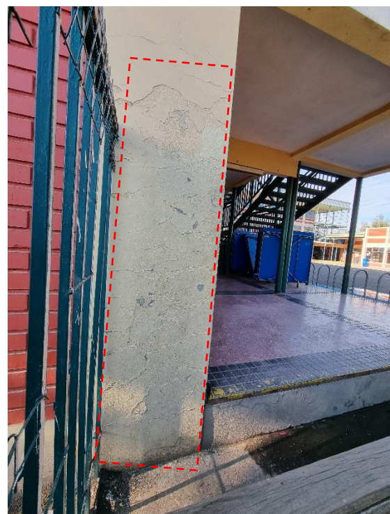
Fotografía N° 28 - Colegio Santa Filomena - Falta de preparación de superficies.
