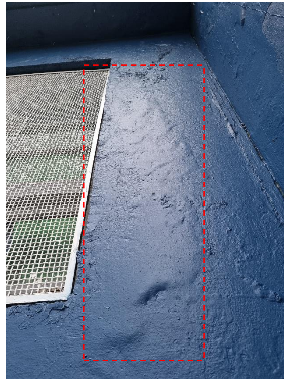
Fotografía N° 32 – Instituto Tecnológico Minero Bernardo O'Higgins – Falta preparación de superficies.
